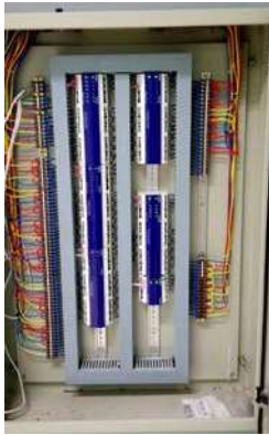
อุปกรณ์ควบคุมเครื่องปรับอากาศ และแสงสว่าง ทำหน้าที่คอยสั่ง ปิด - เปิด
