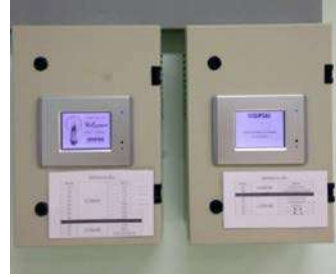
ระบบทัชสกรีน ในการสั่งเปิด - ปิด เครื่องปรับอากาศและแสงสว่าง ในแต่ละชั้น
