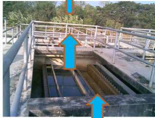
5. รางน้ำสั้นก่อนลงถังกรองทราย
