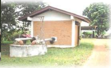
อาคารโรงสูบน้ำดิบ ภายในติดตั้งเครื่องสูบน้ำดิบ จำนวน 2 ชุด เพื่อสูบน้ำจากบ่อกักน้ำไปเข้า parshall flume ของอาคารโรงกรองน้ำ
