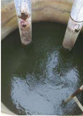
บ่อกักสูบน้ำลักษณะเป็นคสล. ทรงกระบอก
